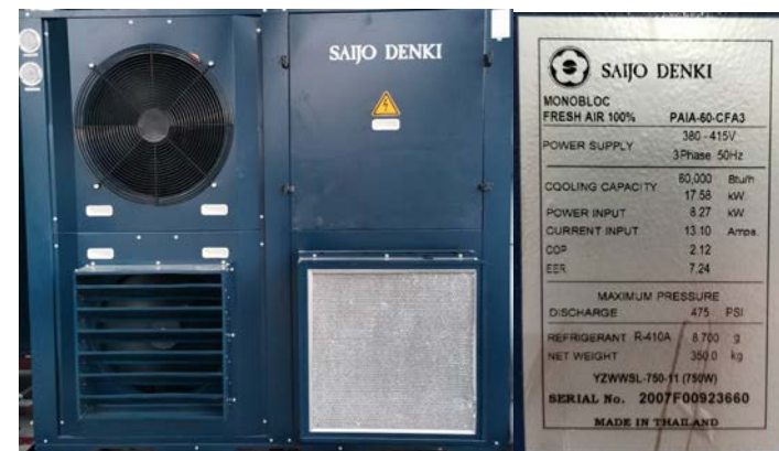
รูปแสดงชุดเครื่องปรับอากาศสำหรับจ่ายลมเข้าห้อง เครื่อง 2
