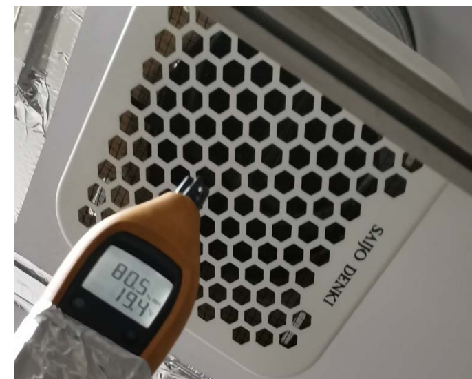
รูปวัดสถานะอากาศออกจากเครื่องปรับอากาศ
