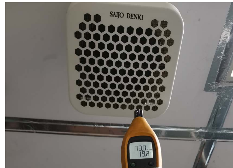
รูปวัดสถานะอากาศออกจากเครื่องปรับอากาศ
