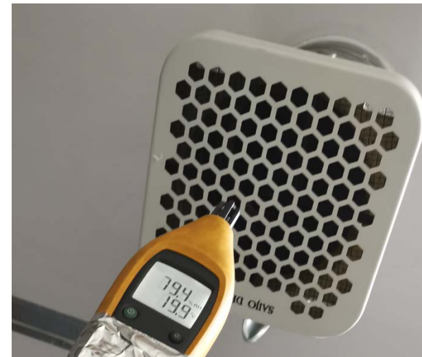
รูปวัดสภาวะอากาศออกจากเครื่องปรับอากาศ
