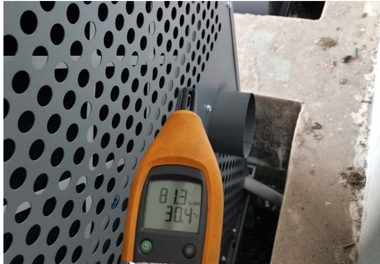
รูปวัดสถานะอากาศเข้าสู่ชุดเครื่องปรับอากาศสำหรับจ่ายลมเข้าห้อง
