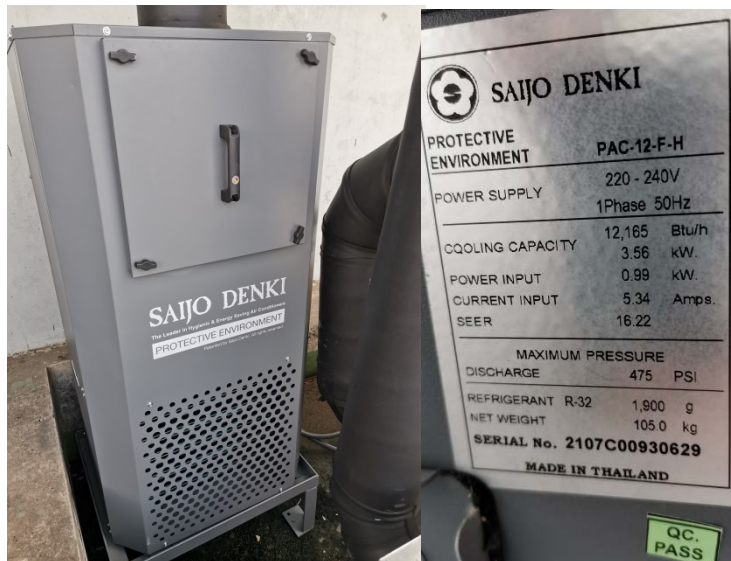
รูปแสดงชุดเครื่องปรับอากาศสำหรับจ่ายลมเข้าห้อง
